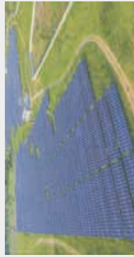
โรงไฟฟ้าพลังงานแสงอาทิตย์แบบติดตั้งบนพื้นดินขนาด 10 MW ที่ Rayachoti
