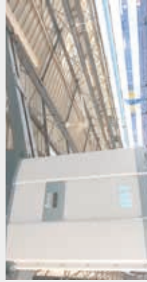
หน่วยแปลงและจ่ายพลังงานจากแสงอาทิตย์ขนาด 1 MW ที่สถานีรถไฟ Vaishno Devi Katra
